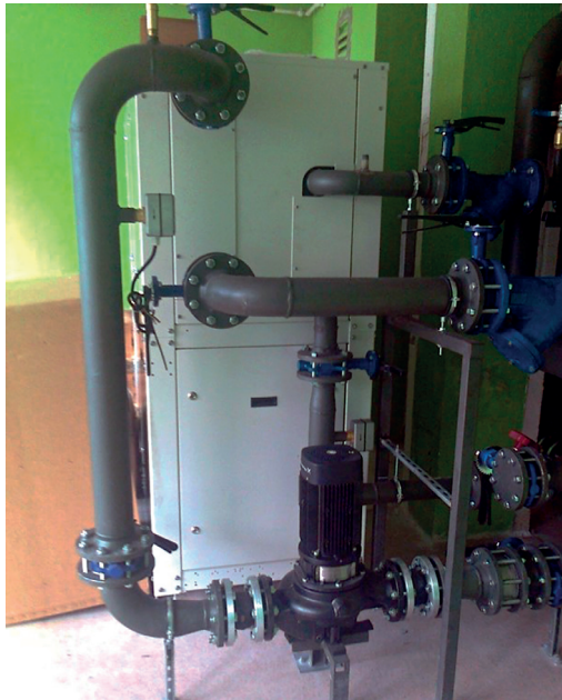
3. ábra. Mórahalom termál kaszkárendszer I. ütem
